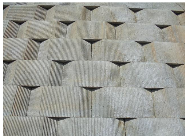
전면부 S4 블록 균열
