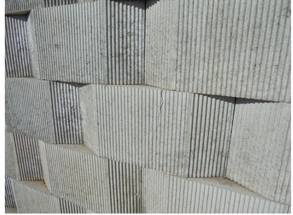
전면부 S3 블록 균열
