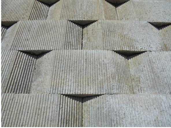
전면부 S3 블록 균열
